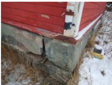
Sprekk mellom steinene
