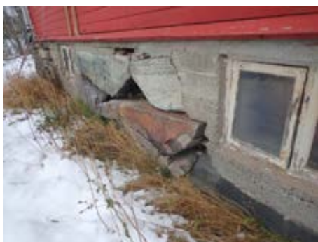
Store skader i muren
