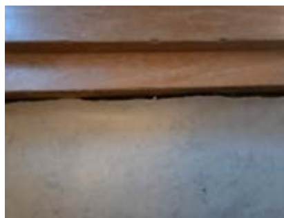
Utett belegg på gulv.
