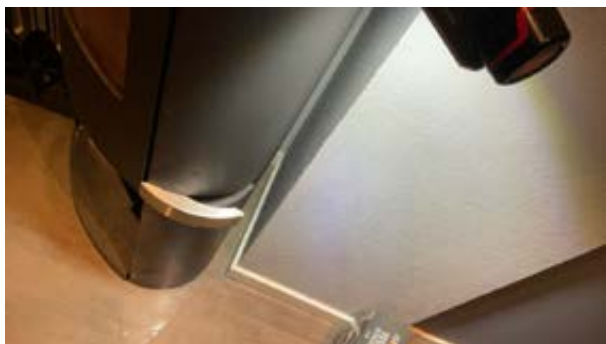
Trolig ikke dobbel elementpipe som vist på tegning.
