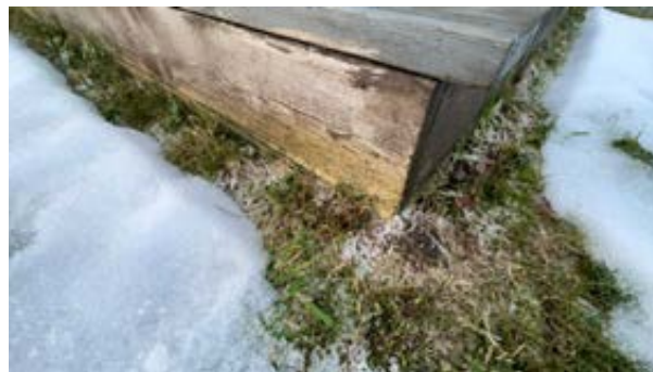
En skade på dekkbord i fremkant av terrasse.
