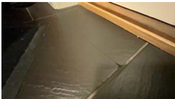
Sprekk og hulrom under flis.
