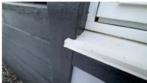
Slitt omramming rundt vindu. Omrammingen ligger helt ned mot beslag.
