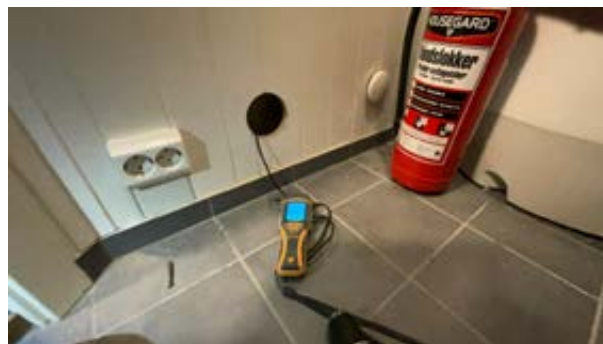
Fuktmåling i vegg på vaskerom.
