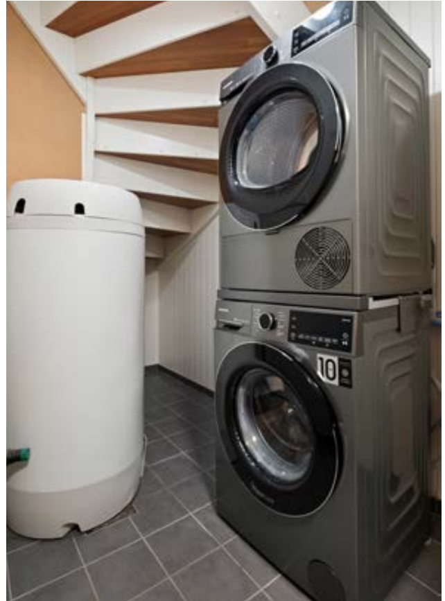
Vaskerommet har flislagt gulv og har opplegg for vaskemaskin/tørketrommel. Vv-bereder er også plassert her
