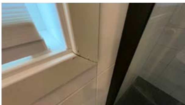
Vindu er plassert i våtsonen og malingen på listen flasser.
