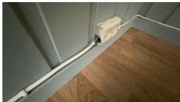
Skade på stikkontakt.
