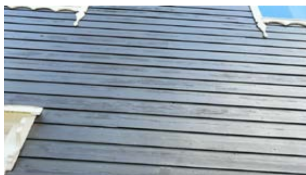
Bilde er fra vestvegg, men kledningen er jevnt over slitt.
