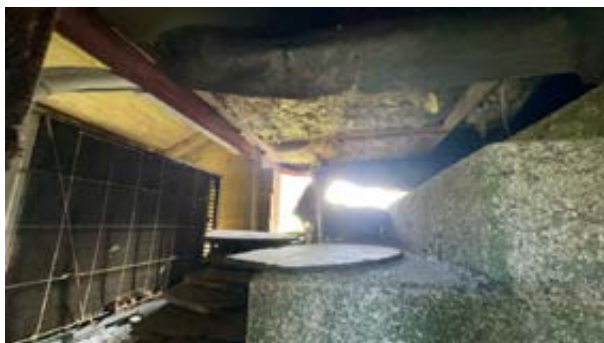
Gulvet på kjøkkenet er eksponert fra undersiden.
