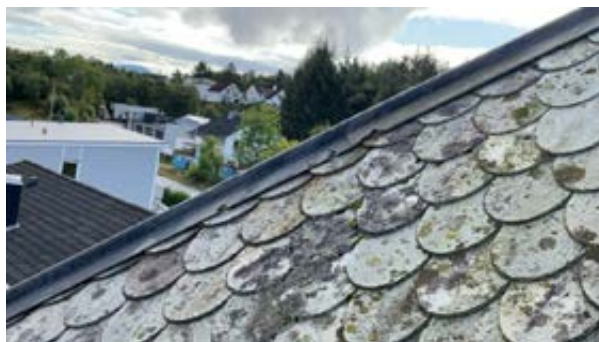
Rust-/ korrosjonsskader i beslag og det er hull i disse.
