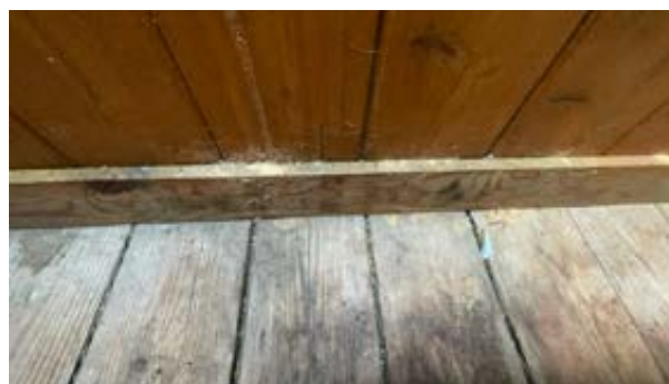
Det er observert borestøv etter borebiller på loftet.
