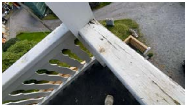
Eksempel på værslitt rekkverk.
