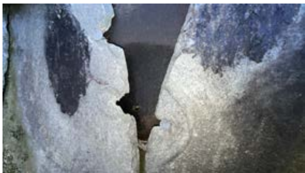
En takstein som er borte og det er synlig hull i undertaket.
