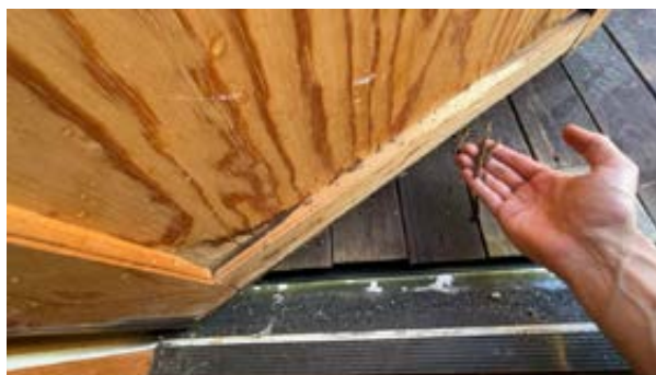
Terrassedøren på loftet har råteskader.
