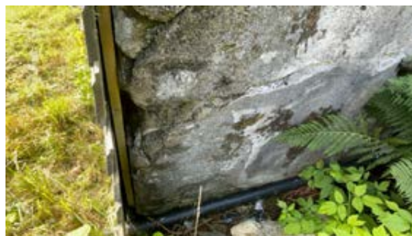
Bakkant av trappen. Det er observert noen sprekker. Omfanget er ikke avklart.
