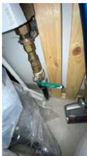
Hovedstoppekran i vaskerom/teknisk rom.
