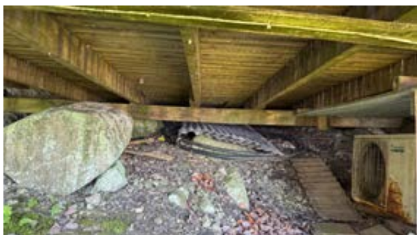
Fellesterrasse har svak konstruksjonsmessig oppbygging.
