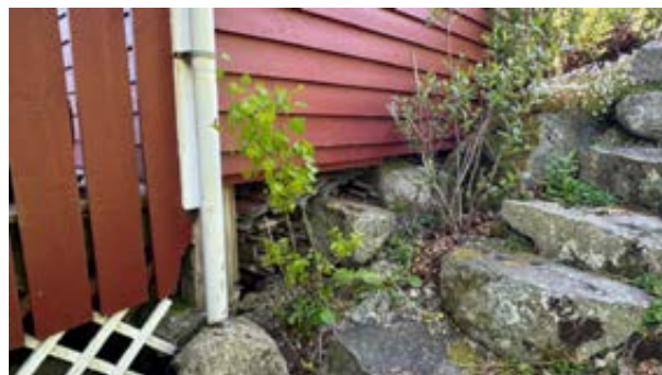
Etasjeskille nær terreng er utsatt for fukt
