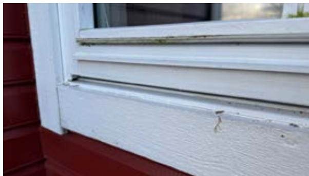
Vindu som mangler vannbord under bunnkarm.
