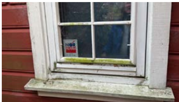
Vindu med vedlikeholdsbehov.
