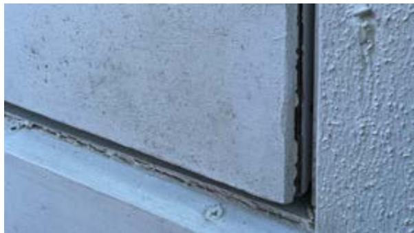
Dørblad for terrassedør med påbegynt delaminering
