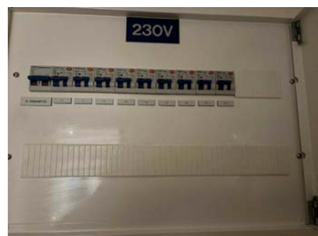
Elskap, plassert i entre.
