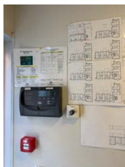
Felles brannvarslingsanlegg i bygget
