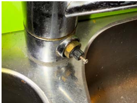
Defekt/falt av krandel for vann til oppvaskmaskin
