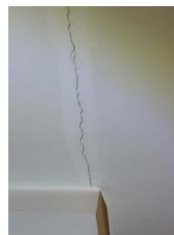
Setningssprekker i 5 veggplater
