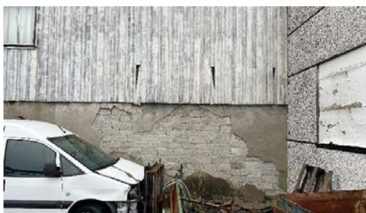
Dårlig tilstand på fasadepuss
