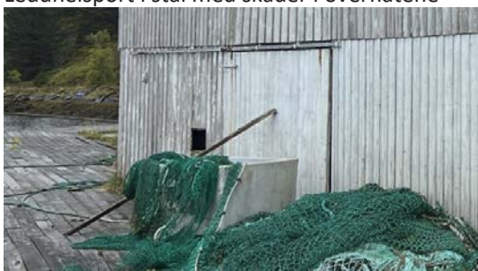
Eldre treport med råteskader og rustne beslag
