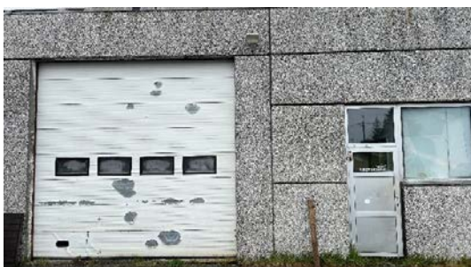
Leddheisport i stål med skader i overflatene
