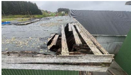
Hull i taket med mye råteskader
