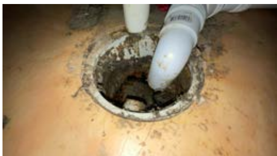
Sluk under dusjkabinett.
