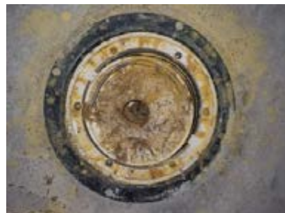
Plastsluk uten synlig tettesjikt.
