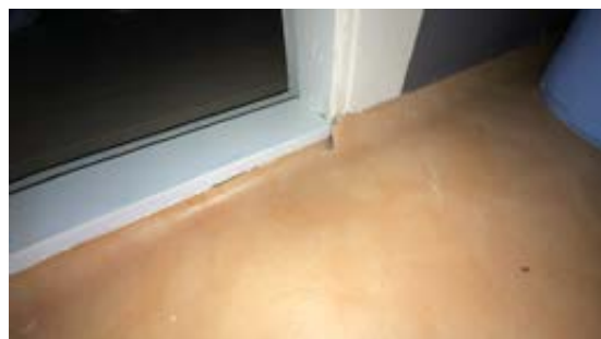
Sprekk i belegg/tettesjikt ved dør.
