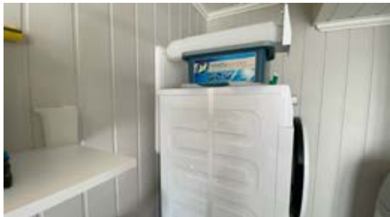
Rør i rør sentral bak tørketrommel.
