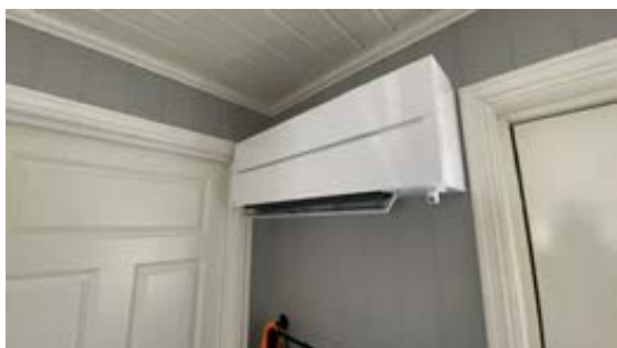
Varmepumpe plassert på yttervegg i entre.
