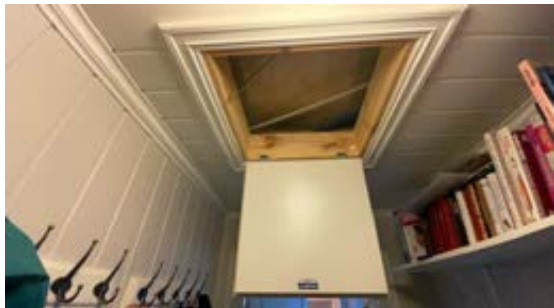
Begrenset tilgang for kontroll av innvendig takkonstruksjon.
