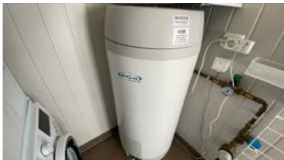
Varmtvannsbereder på vaskerom.
