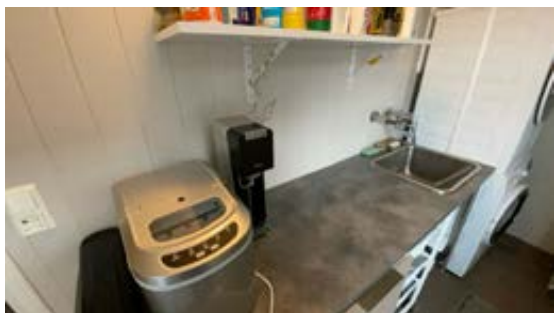
Ikke fuktbestandige plater i våtsone ved innredning/vask.
