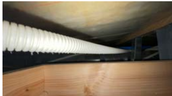
Åpning mellom nedsenket himling og takkonstruksjon.
