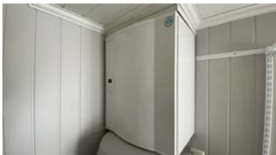
Systemair ventilasjonsaggregat på vasdkerom.
