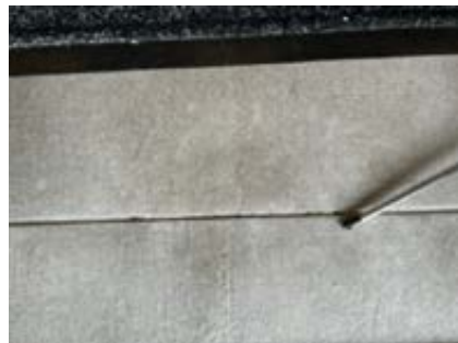
Flis ved ytterdør, sprukket fuge
