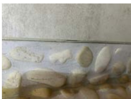
Glippe i fuge mellom bunnprofil og baderomsplate
