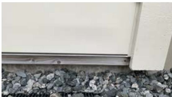
Beslag ikke montert, dør ved garasje/sportsbod
