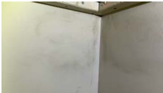
Misfarging under kontorpult første etasje
