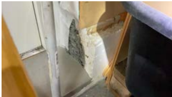
Synlig brennbar isolasjon
