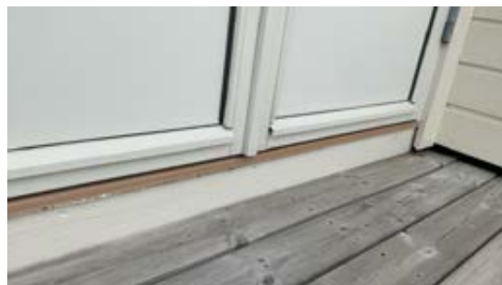
Ikke beslag under dører andre etasje
