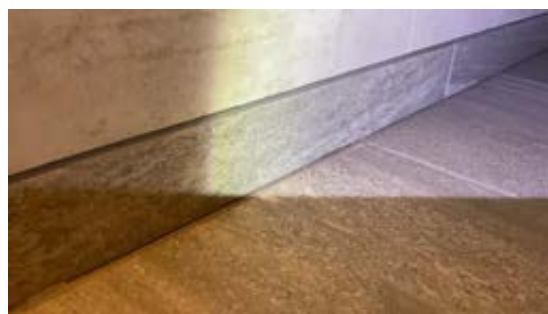
Glippe fuge mellom gulv og sokkelflis
