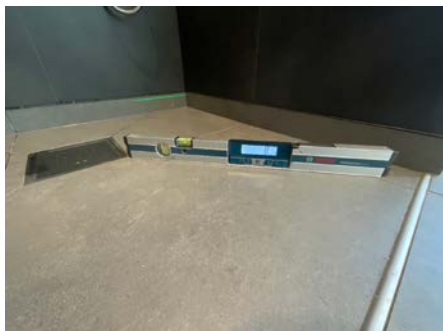
Avvik på lokalfall i dusjen.
