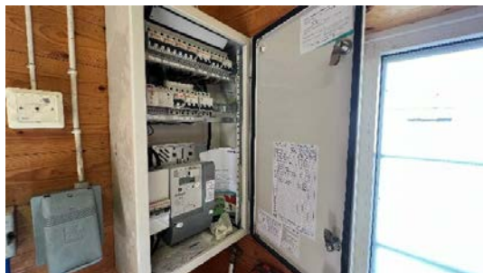
Fordelerskapet er plassert i innredet rom lengst sør.
