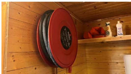
Brannslange og hånslokker.
