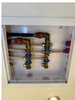
Rørskap i badromshimling med 2 x stoppekraner
