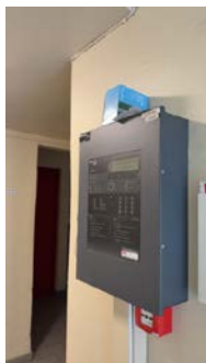
Felles brannvarslingsanlegg i bygget
