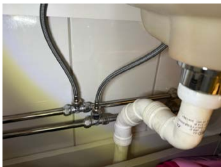
Røropplegg i servantskap
