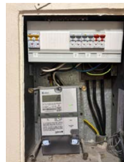
Elskap, plassert i felles trappegang.
