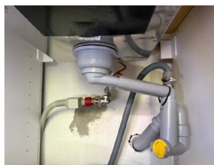
Røropplegg i kjøkkenbenk
