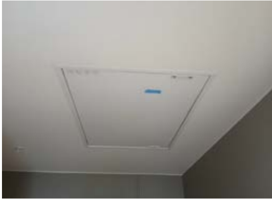
Figur 10 Eksempel på takaggregat i leilighet
