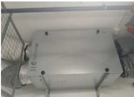
Figur 9 Eksempel på aggregat i bod i kjeller
