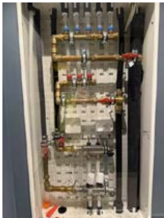
Figur 5 Innside av vannskap
