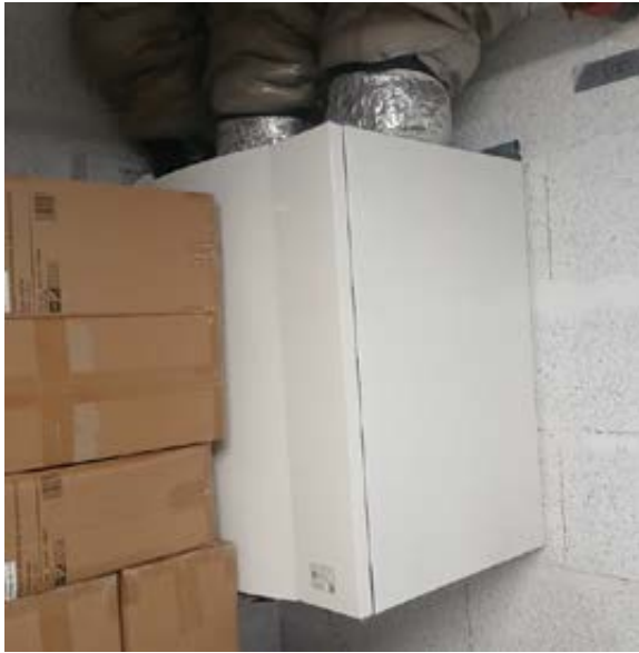
Figur 8 Eksempel på aggregat i bod i garasje
