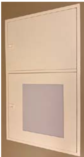
Figur 15 Sikringsskap i leiligheten
