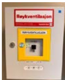
Figur 4 Panel for røykventilasjon
