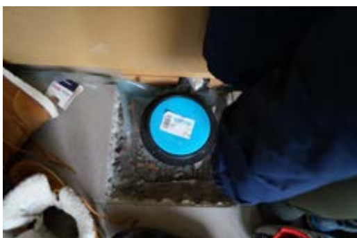
Mangelfull fuksikring på gulv i utvendig bod
