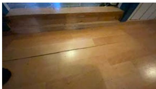
Gang: svikt mellom bordene i laminatgulvet.
