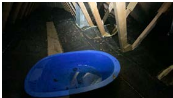
Kar for oppsamling av lekkasjevann fra taklekkasje.
