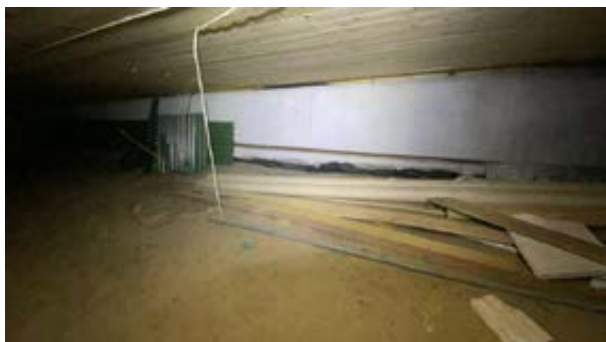
Krypekjeller med sandgulv uten fuktspærre.
