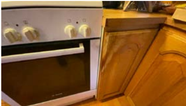
Synlig skade på skapdør ved komfyr
