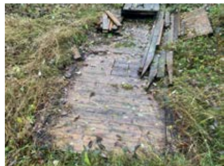
Lokk av tre på septiktank
