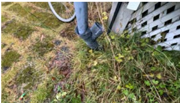
Drensrør benyttet til taknedløp tyder på at det er montert drensrør i grunn.
