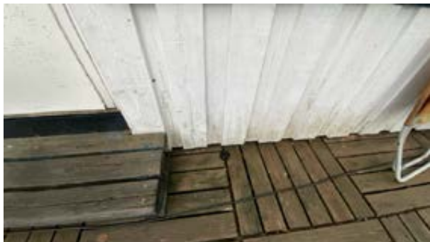
Bord med sprekkdannelse ved balkongdør.
