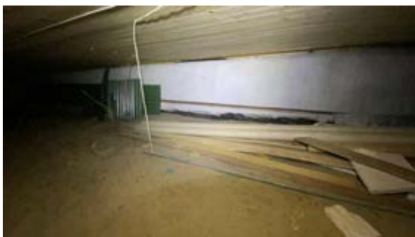
Ringmur i betong. Masse seget vekk fra mur mellom søylepunkter. Søylepunkt synlig
