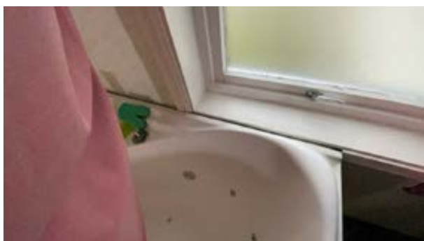
Badekar like ved vindu uten fuktsikring
