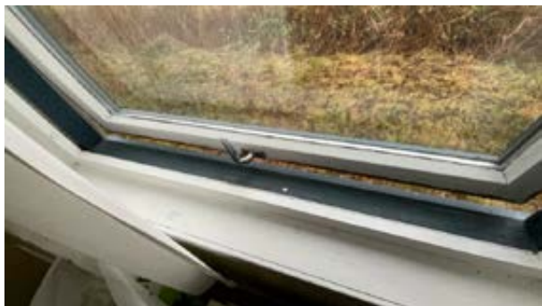
Åpningsbart vindu med bruksslitasje
