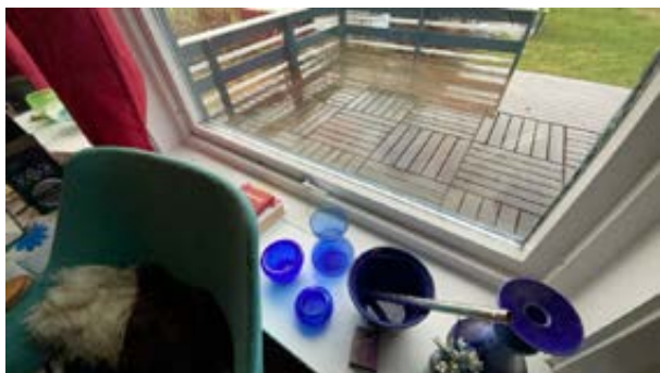
Punktert vindu i stue
