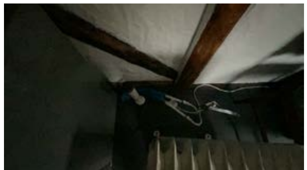
Vanntilførsel til spiserom ved inngang uten tetting.
