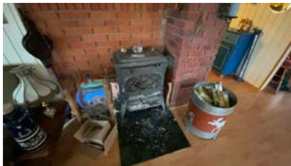
Vedovn tilkoblet pipe i stue
