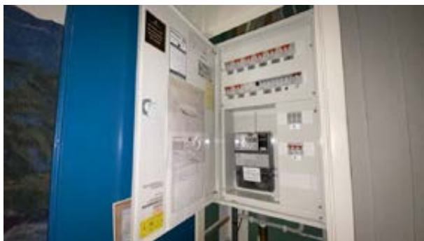
Sikringskapp i gang
