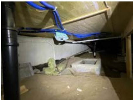
Vannrør i krypekjeller.
