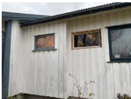
Midtre vindu mangler beslag/ tilslutning til kledning.
