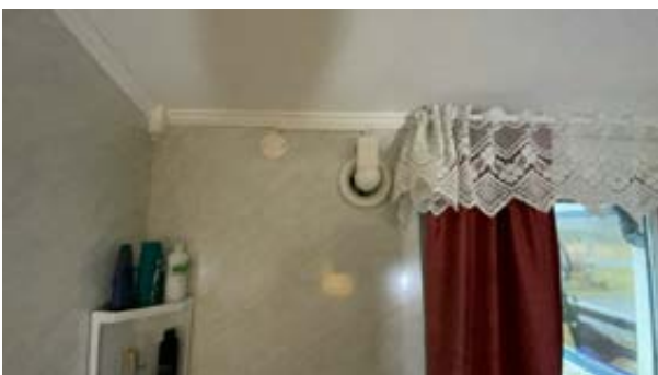
Vifte i vegg
