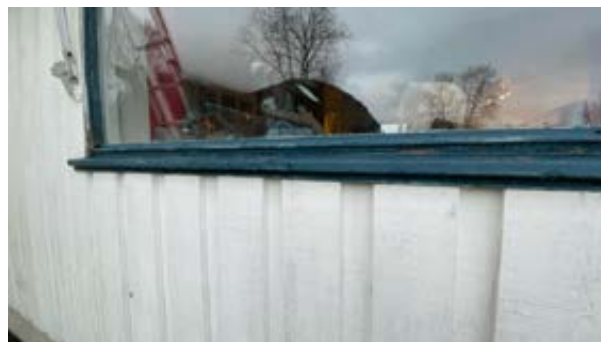
Utvendig fukt/ aldersslitasje på vindu.
