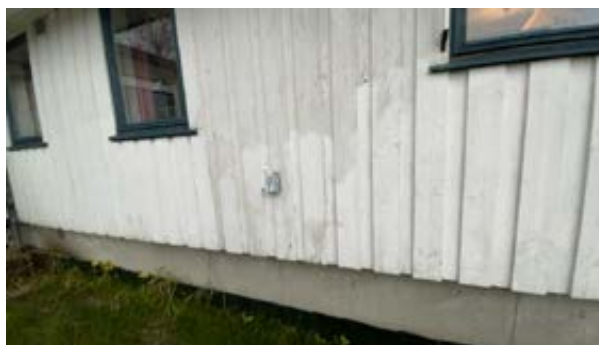
Malingsbehandling på kledning er svært slitt.
