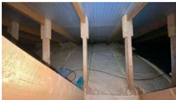
Manglende lufting ved takfot.
