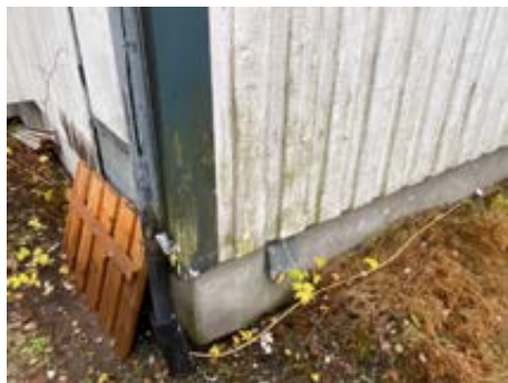
Godt synlig grønske/ sopp på vegg
