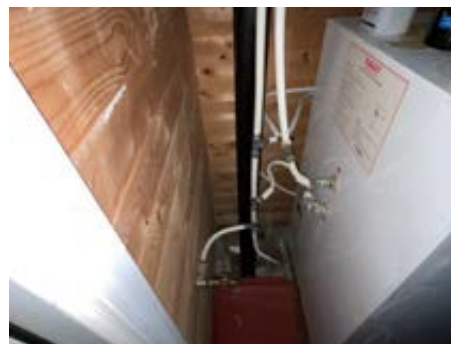
Rørtilkobling bak bereder.
