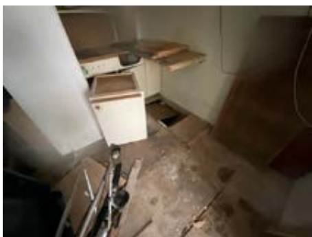
Gulv i utebod er defekt/ råteskadet.
