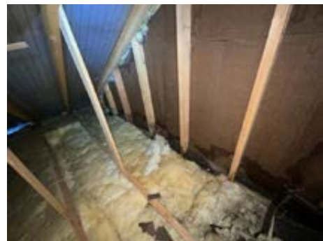
Synlig fukt i asfaltplate og på svill.
