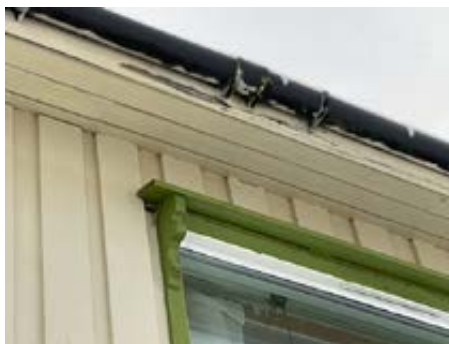
Råteskade i forkantbord under takrenne
