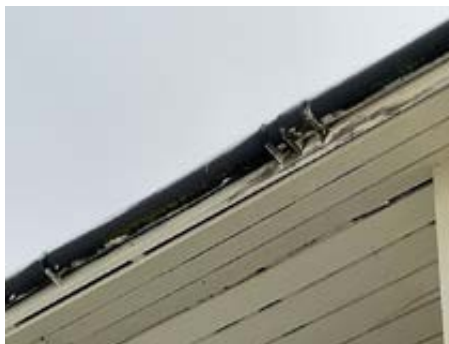
Råteskade i forkantbord under takrenne
