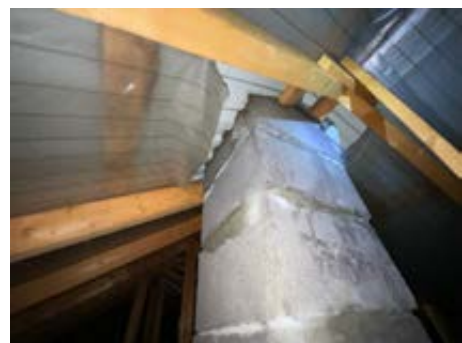
Undertak kuttet rundt pipe uten oppbrett/ undertaksbeslag.
