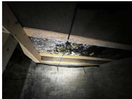
Fuktskader i etasjeskiller under bad.
