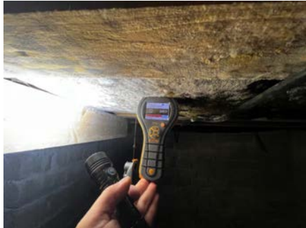
Fuktskader i etasjeskiller under bad.
