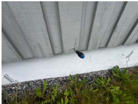
Råte på vestvegg.
