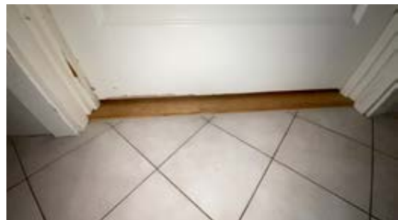
Tilluftsspalte under dør. Synlig skade på dør og karm
