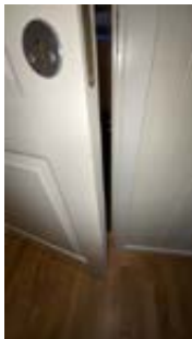
Skade på karm og dørblad mot vindfang.
