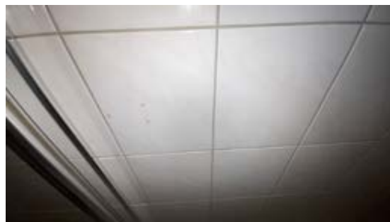
Eldre skruehull er forseglet med mykfuge. Er noe riss/sprekk i flis på en side.
