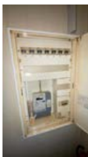
Sikringsskap har synlig misfarging som følge av tobakksrøyk
