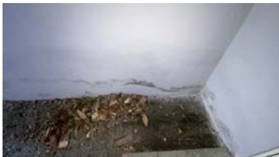
Saltutslag/fuktopptrekk på baksiden ved inngang til bod/teknisk rom
