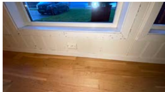
Slitasje og hakk på parkettgulv i leiligheten
