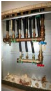
Vannfordelingsskap. Drypplekkasje fra fordelingskolbe varmtvann. Skapen mangler avrenning/lekkasjesikring
