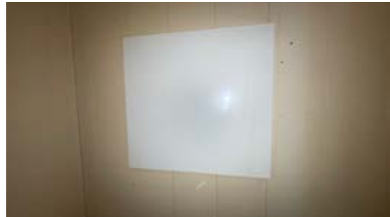
Luke/deksel over vannfordelingsskap
