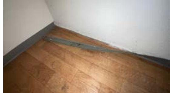
Det er løsnet kantlist mellom gulvbelegg og mur mot øvre hjørne.
