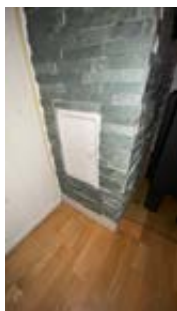
Mangler plate på gulv under sotluke
