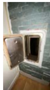
Mangler sotlukestein for å sikre avstand mot brennbart materiale ved sotluke
