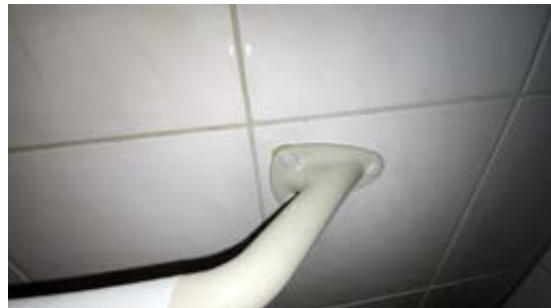
Sprekk i flis ved håndtak i dusj
