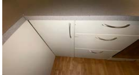
Skader på kjøkkenfronter
