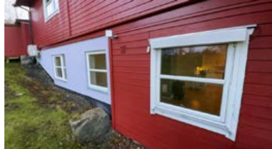
Anbefaler å smøre låser/låsesystem på åpningsvinduer for å sikre lettere åpning
