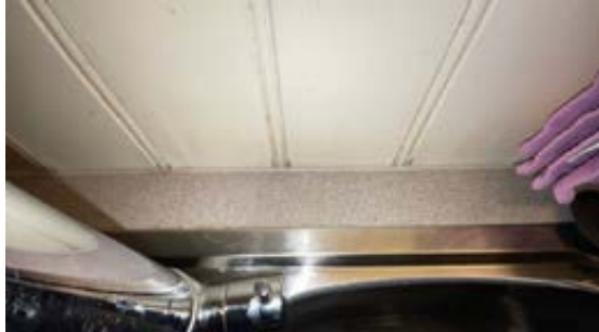
Det er skader på veggplate på vegg ved benkeplate
