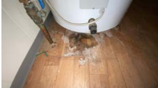
Synlig misfarging på belegg som følge av drypplekkasjer på varmtvannstank
