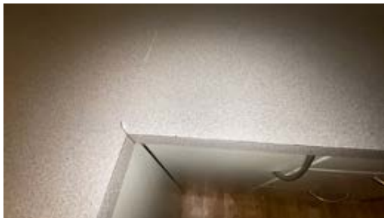
Noe kantslitasje/hakk på benkeplate
