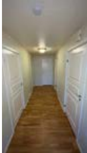
Dør til soverom, bod, bad/vaskerom og vindfang sett fra gang. Dør til ett soverom tar i bunnterskel.
