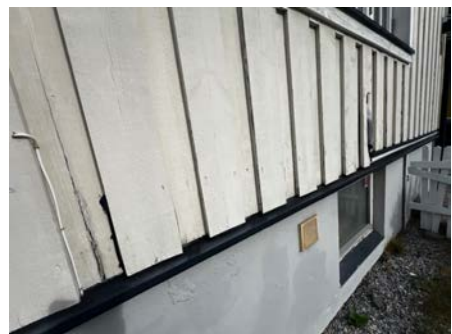
Værslitt og dårlig vedlikeholdt.
