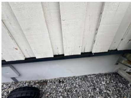
Værslitt og dårlig vedlikeholdt.
