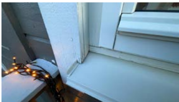
Noe værslitt vindusbelistning.
