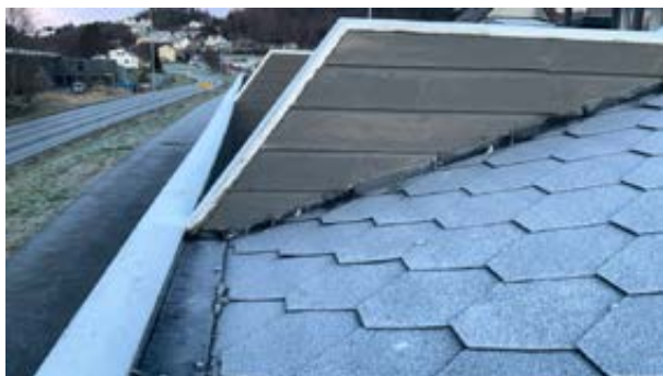
Værslitt levegg/ skillevegg og boden har ikke korrekt overgang mot skillevegg.
