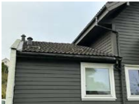
På halvtak mangler flere stigtrinn på tak TG 3.
