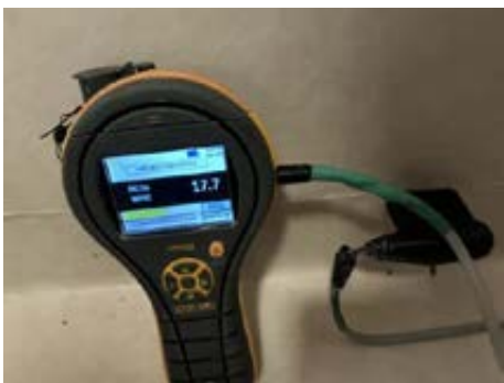
Fukt-søk i vegg under dusj.
