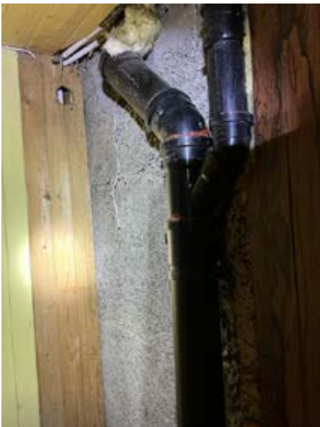
Grunnmur med synlig siporex i innvendig kjeller.
