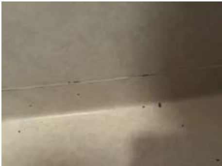
Glippe/sprekk i belegg/membran under dusjsone.
