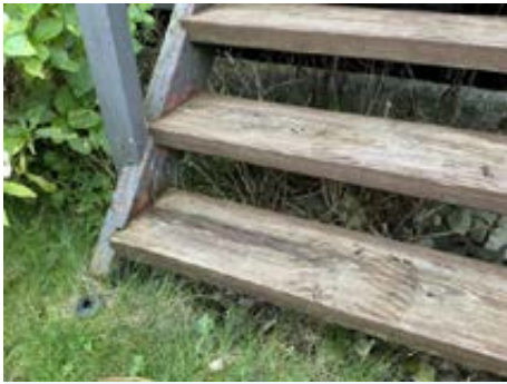
Fukt/råte skade på noen trinn.
