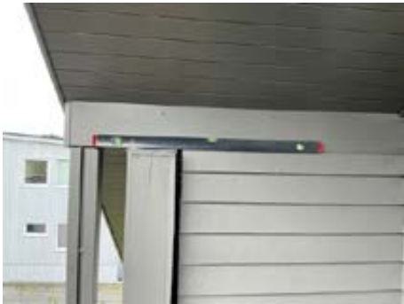
Noe sig i konstruksjon over balkong.
