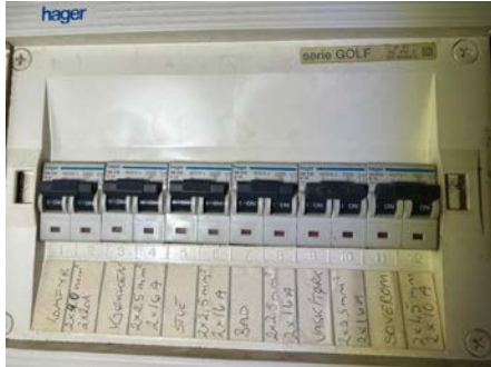
Automatsikringer med skap i entre.
