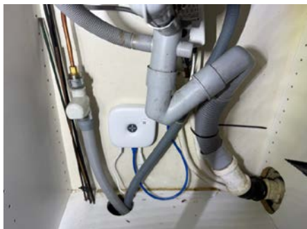
Røropplegg i kjøkkenbenk
