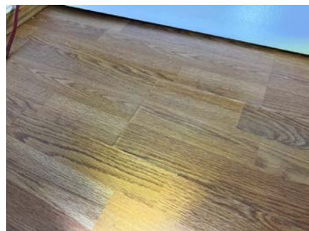
Svelleskader i flere gulv.
