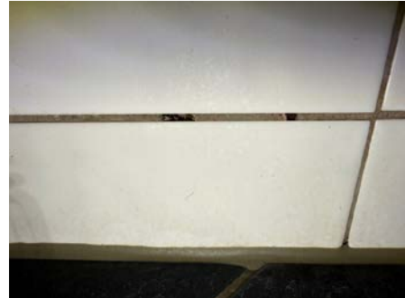
Riss/småsprekker i flee flisfuger i dusjsone.
