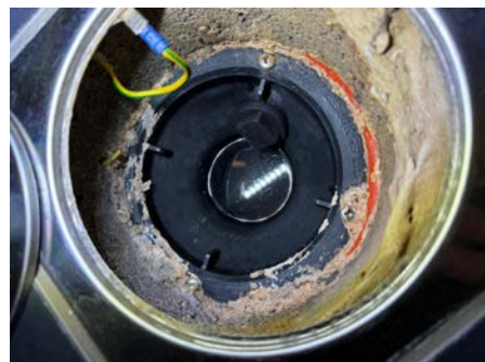
Sluk i dusjsone
