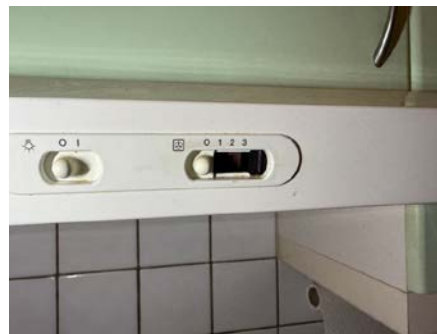
Defekter i bryter på ventilator.
