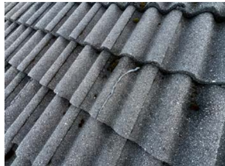
Eksempel på sprukket takstein.
