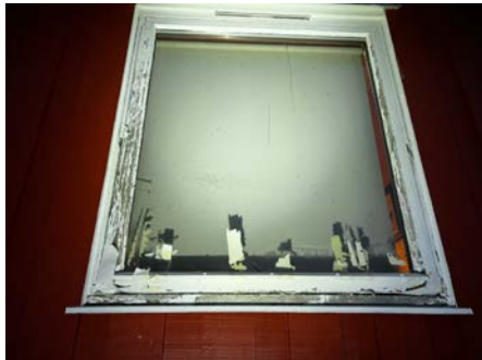
Råte og fuktskadet vindu.
