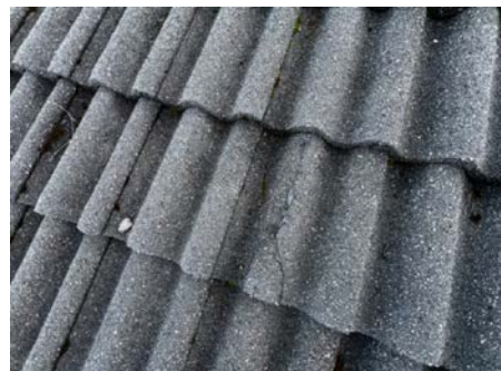
Eksempel på sprukket takstein.
