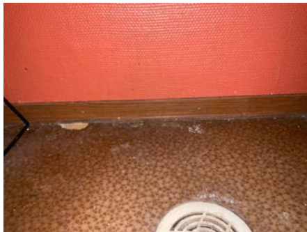
Vinylbelegg på gulv er ikke ført opp langs veggene.
