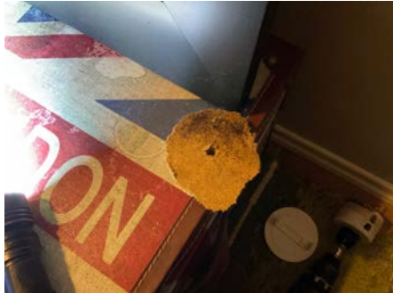
Synlig fukt på veggplaten mot soverom.
