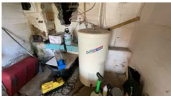
Varmtvannsbereder i kjeller.
