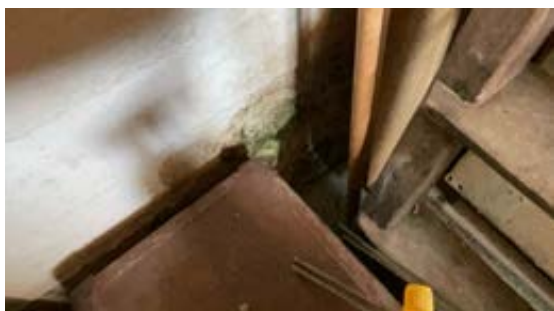
Visuelle tegn på fuktvandring gjennom yttervegg ved kalk/saltutslag.
