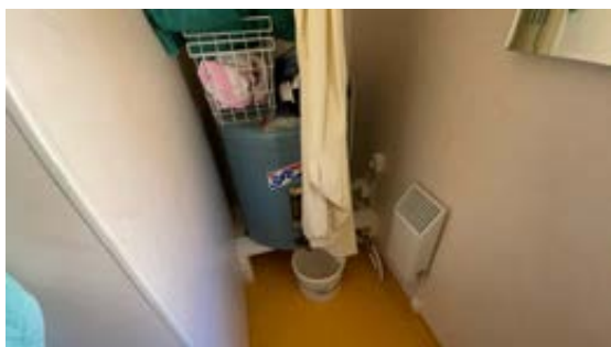
Varmtvannstank på bad i 2. Etasje
