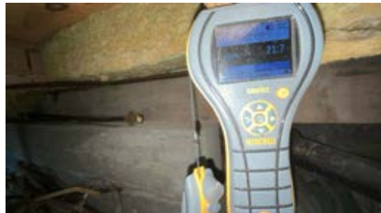
Det ble målt 21,7 vekt% fukt under bjelkelag.
