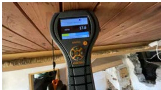
Det ble målt 17,6 vekt% fukt i tak i kjeller.
