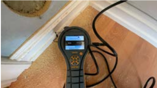
Piggmåling viste under 7 vekt%.
