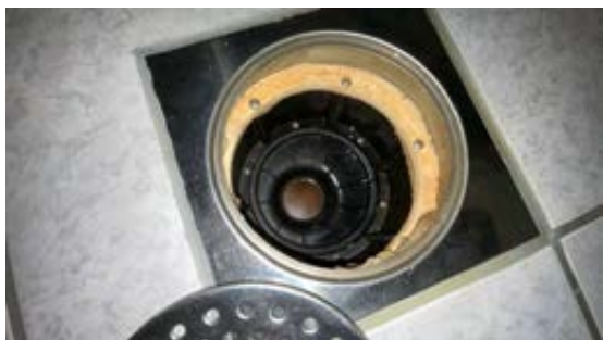
Sluk i dusjnise med synlig tettesjikt underklemring.
