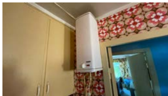
Vegghent varmtvannsbereder på kjøkken 2. Etasje.
