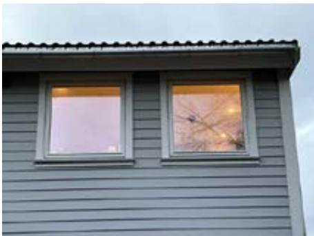
Utvendig omramming på vindu. Tetting er skjult i konstruksjon og er ikke tilgjengelig for kontroll.
