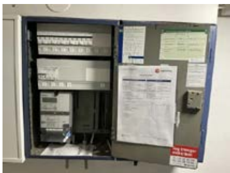
Sikringsskap står i felles gang i kjeller.
