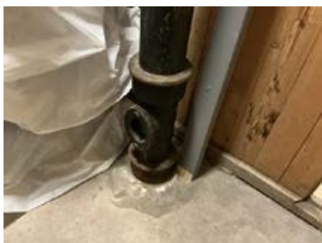
Avløps-rør i støpejern.
