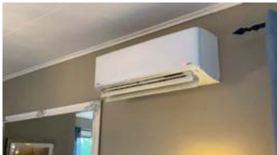
Varmepumpe på vegg i stue 1. Etasje.
