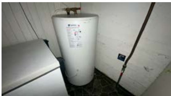
Varmvannsbereider i vaskrom.
