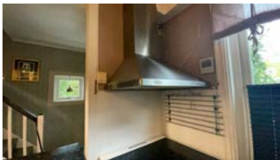
Ventilator på vegg.
