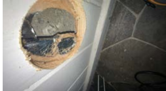
Papp med folie mot grunnmur, ingen synlig isolasjon/diffusjonssperre.
