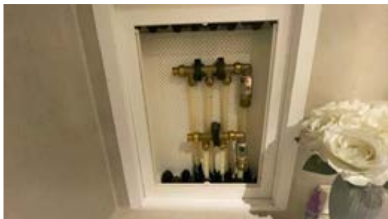
Rørskap på bad i 1. Etasje.
