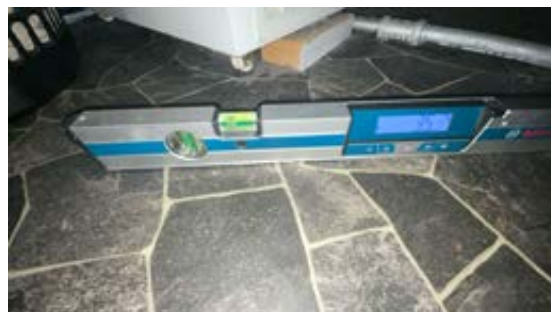
Det ble målt fall på 19-35 mm/meter, og 100 mm nivåforskjell på topp slukrist til tettesjikt ved dør.
