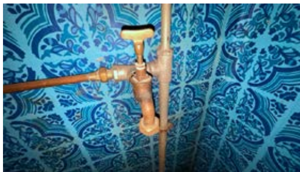
Vannet er frakoblet som følge en drypplekkasje fra rørkobling med kranen.
