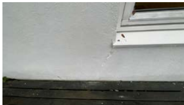
Sprekk i grunnmur.
