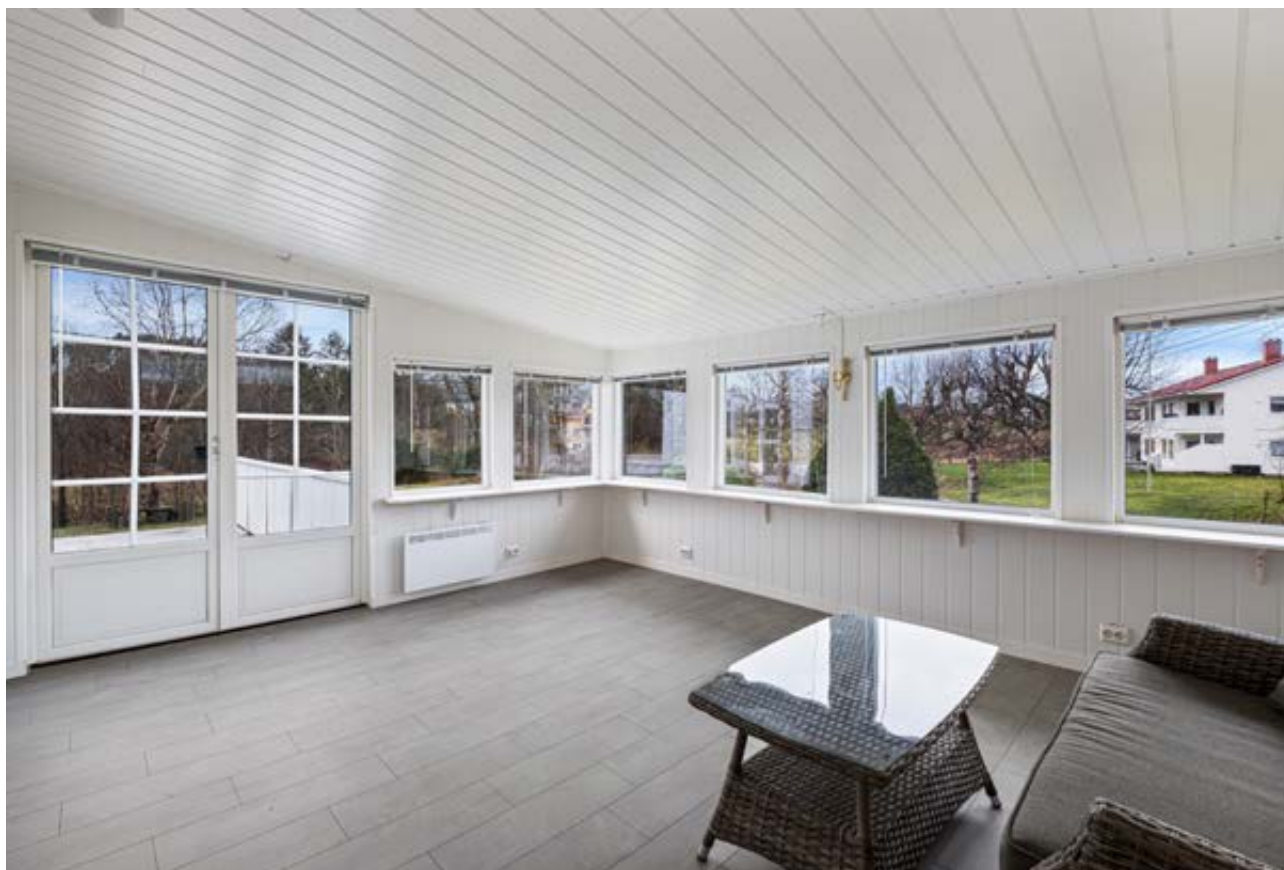
Den tilbygde uestuen er ikke byggemeldt
