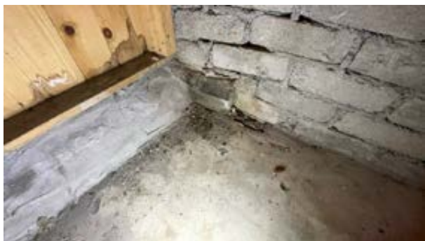
Fuktnntrengning i mur og eldre fuktskjolde på panel.
