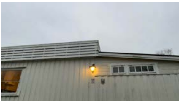
Råteskade på gesims.
