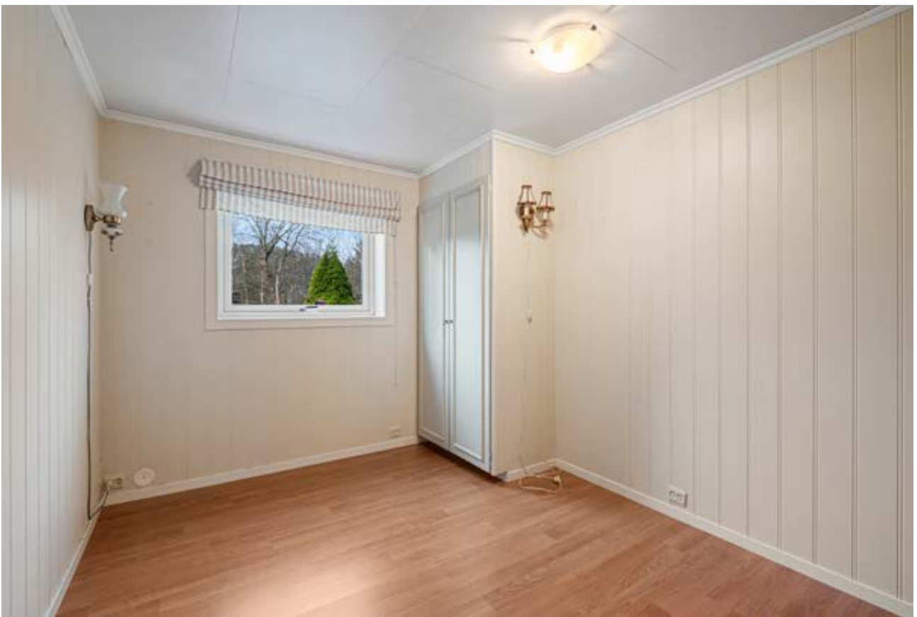
Rom brukt som soverom (øst). Rommet er byggemeldt/godkjent som uterom (ikke godkjent for varig opphold). Det er ikke søkt om bruksendring
