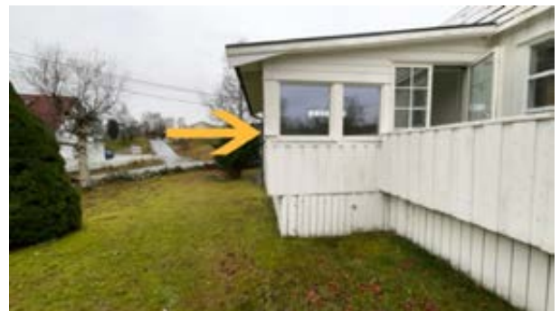
Det ser ut som om veggen går noe utover på midten.
