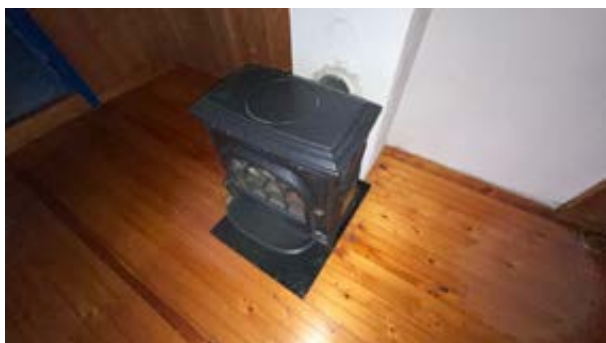
Det må monteres tilstrekkelig plate på gulv fremfor ildsted.
