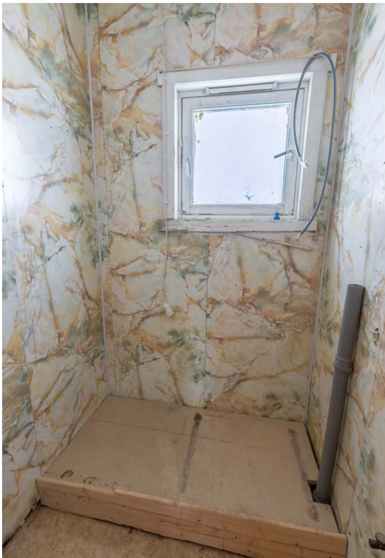
Vaskerommet fra byggeåret har våtromsplater og behov for oppgradering for å tåle dagens bruk.
