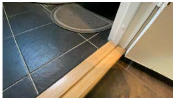
Dørterskel uten luftespalte ved dør.
