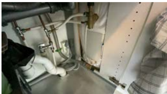
Varmtvannsbereder plassert i kjøkkenbenk.
