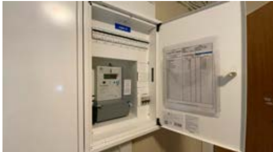
Sikringsskap i felles gang/trappeoppgang.
