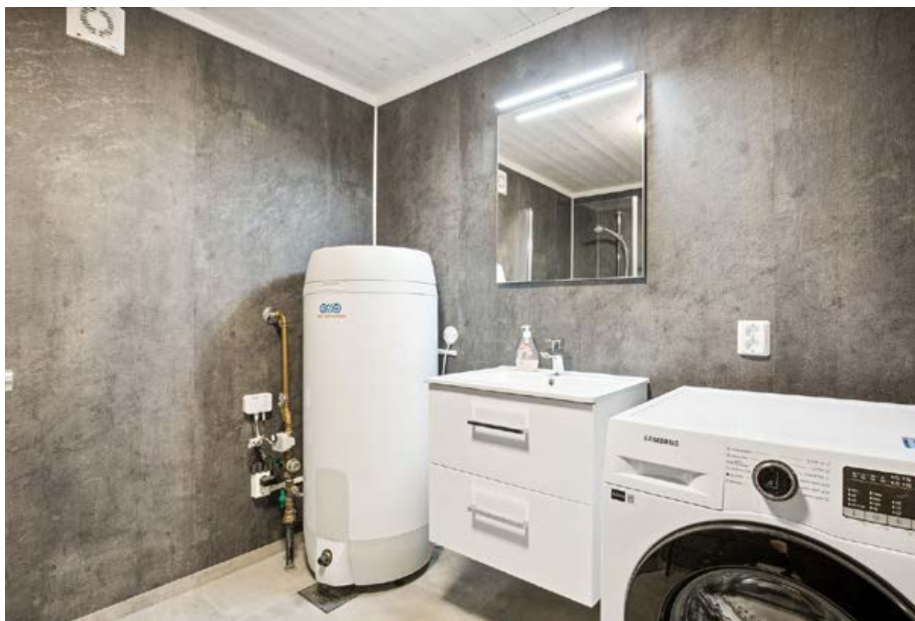
Pent og moderne baderom
