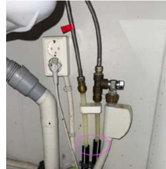
Manglende tettemuffer i benkeskapet på kjøkkenet.
