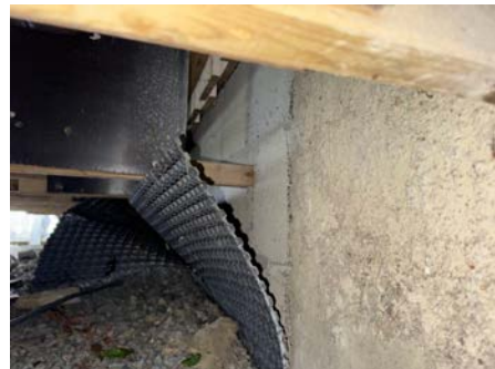
Knotteplasten henger ut fra vegg.
