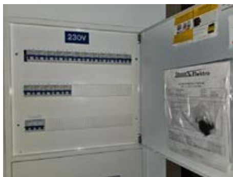
Sikringsskap med automatsikringer og kursfortegnelse
