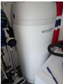
Varmtvannstank ca 200 liter på vaskerommet
