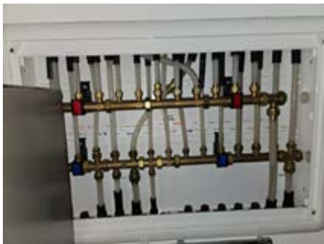
Fordelingsskap for tappevann
