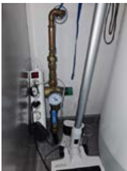
Reduksjonsventil og stoppekran
