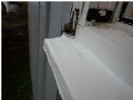
Råteskade kledning ved vindu vest
