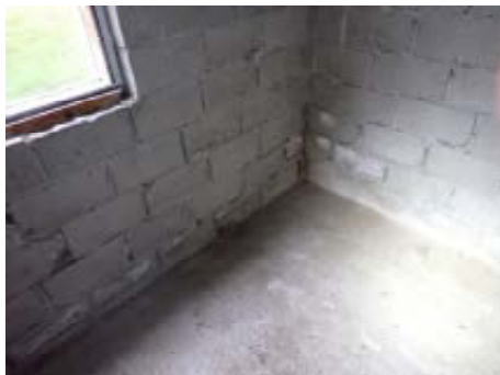
Noe lite saltutslag innvendig mur
