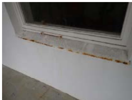
Rustskader vindusbeslag mur
