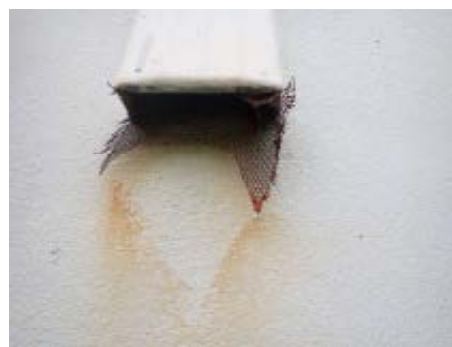
Netting i ventiler løs/rustet
