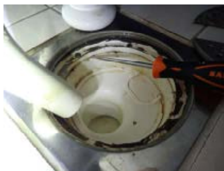
Viser hull i sluk
