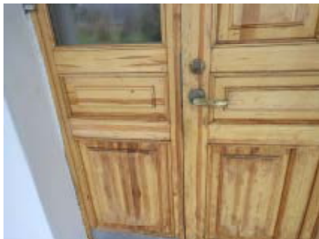
Korrosjonsskader på lås/vrider og ellers noe overflateslitasje
