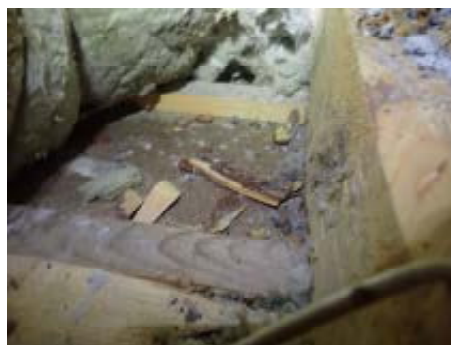
Ingen dampspærre mot 1 etg
