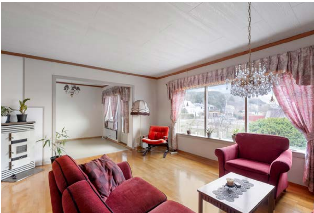
Varmepumpe installert i stuen sørger for energieffektiv oppvarming.
