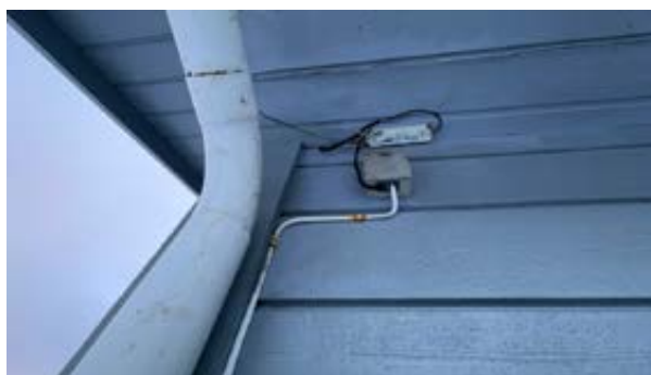
Utvendig kobling som ikke ser fagmessig ut.
