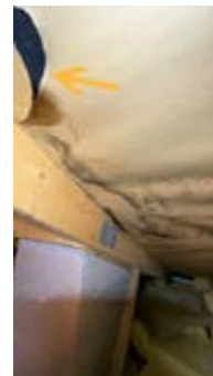
Skade i undertak og fuktskjolder.
