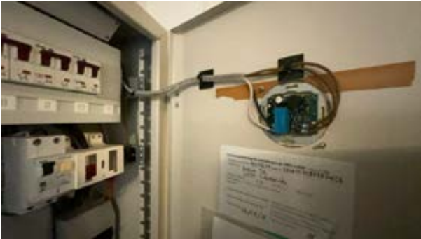
Deler av installasjonen fremstår med eksponerte ledninger på dør.
