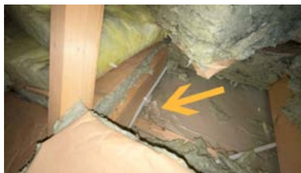
Kondensdråper på undersiden av platen.
