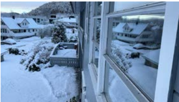
Tendenser til værslitt vindu.
