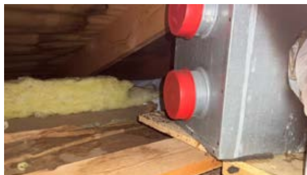
Det er noe fukt ved ventilasjonsaggregat.
