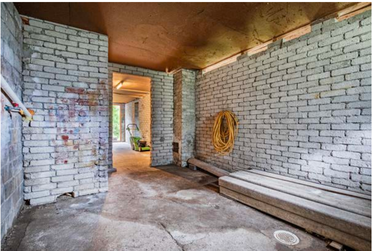
Rom med sluk og vannkran
