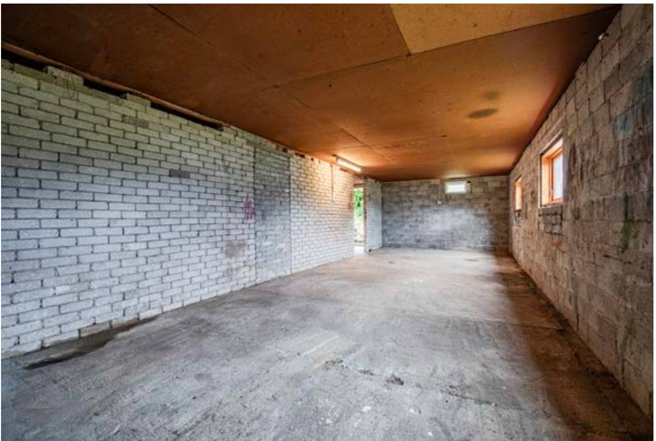
Det er stort potensiale i kjelleren
