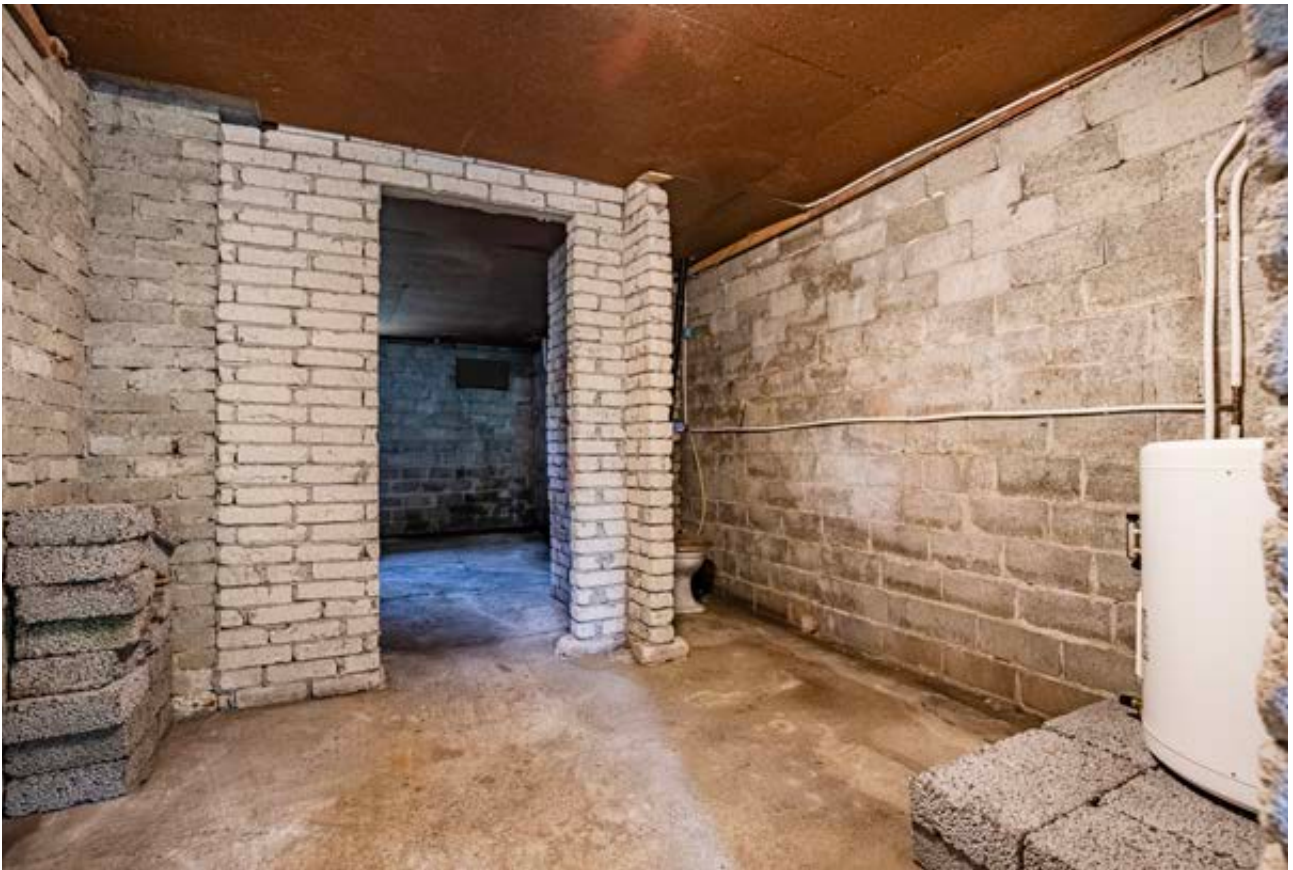
Varmtvannstank er plassert i kjeller, og det er opplegg for WC
