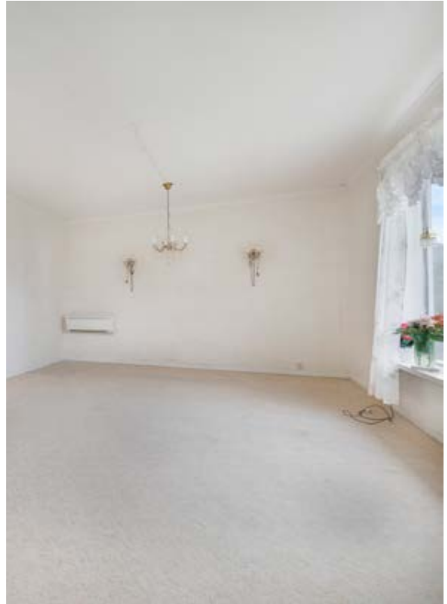
I spisestuen er det montert en varmepumpe, sist service i 2024
