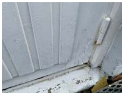
Fukt/råteskade dør til kjeller
