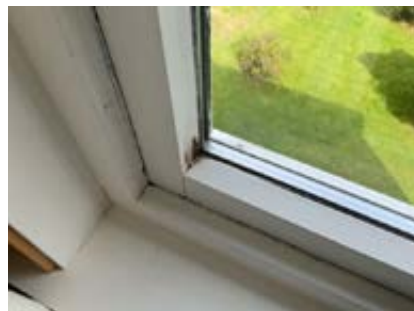
Innvendige fuktmerker soverom andre etasje
