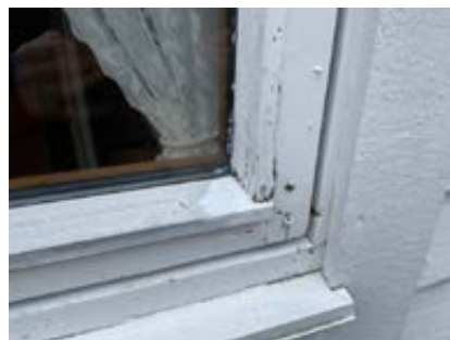
Fukt/råteskade, skrudd igjen
