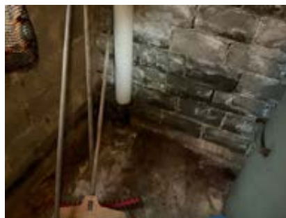
Synlig fukt kjellermur v/oljetank
